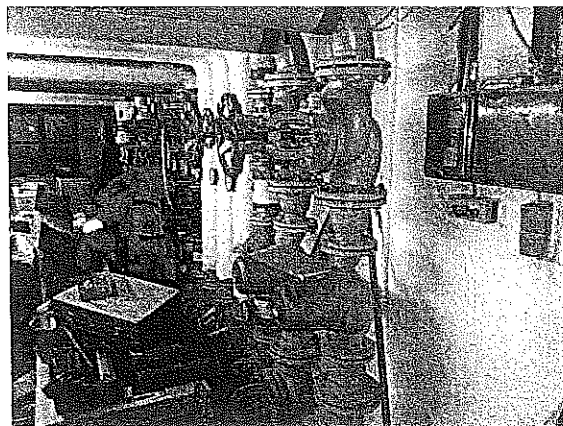
Zentraler Heizkreisverteiler Schule
