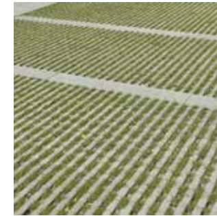
Rasenliner. Begrüntes und sickerfähiges Pflaster (grau) aus gefügedichtem Beton mit linearen Rasenfugen.
