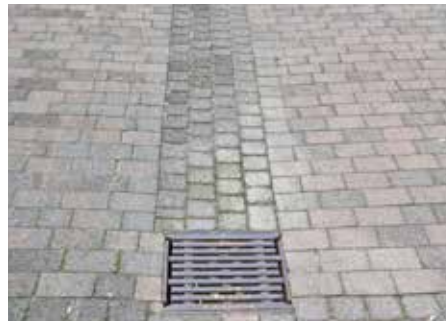
Kontrastierende lineare Entwässerungsrinne
